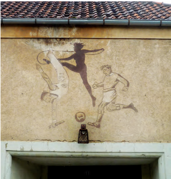
Bild in einer Putzfassade
