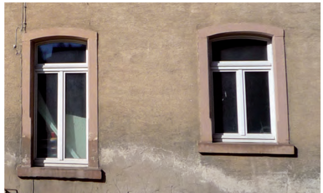
Galgenfenster in Putzfassade
