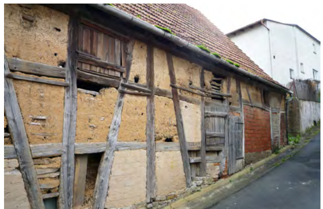
Erhaltungsmängel an Nebengebäuden
