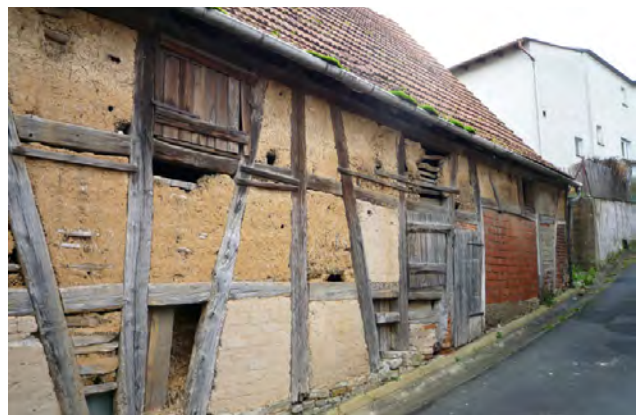
Erhaltungsmängel an Nebengebäuden
