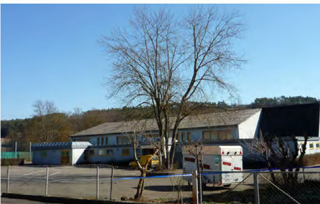
Festhalle mit Sanierungsbedarf
